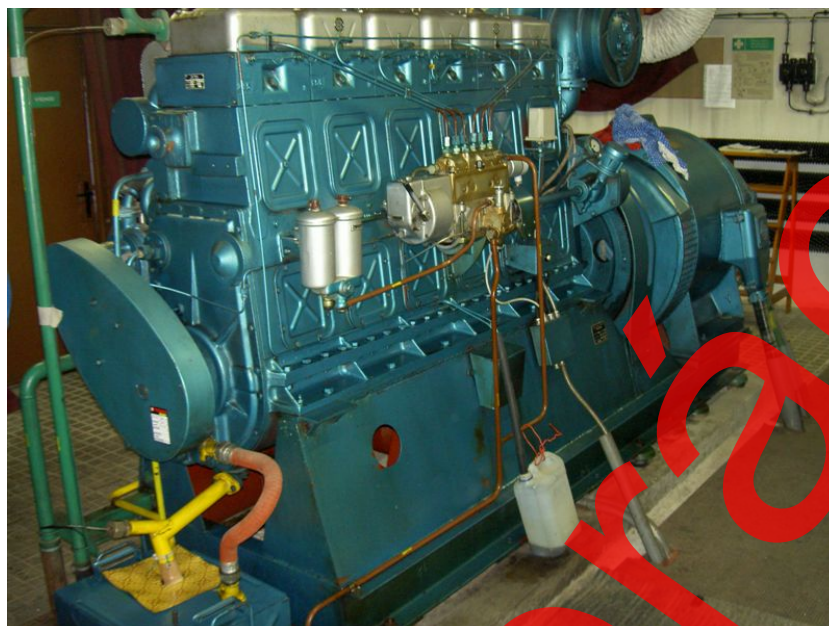
Obr. 4: Soustrojí chlazené pomocí průtoku vody
